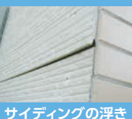
サイディングの浮き
