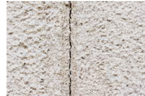
モルタル壁のひび
