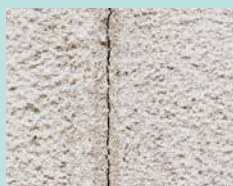
モルタル壁のひび
