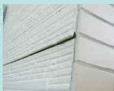
サイディングの浮き
